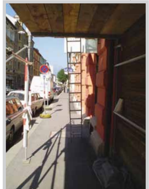
Negativbeispiel. Eine Leiter wird zur Gefahrenquelle für blinde Fußgänger.
